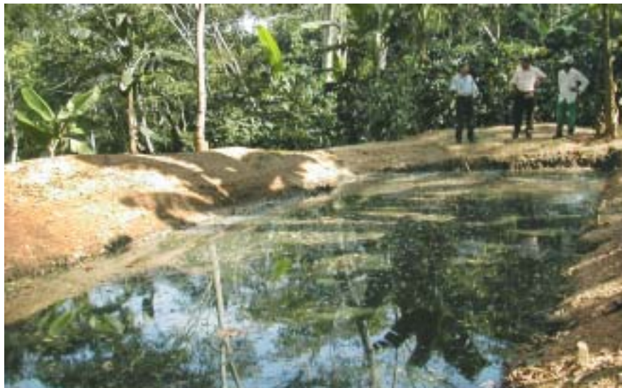
Pilas de oxidación para el manejo de aguas residuales producto del beneficiado de café. Estas pilas permiten verter aguas menos contaminadas hacia las fuentes de agua superficial de la microcuenca.
