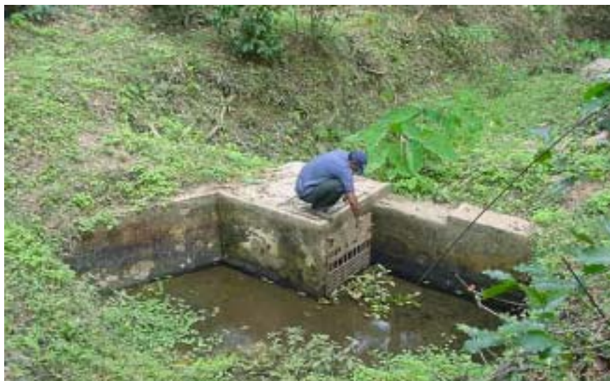
El estado de las obras de toma y la cantidad de agua retenida en las mismas es limitada y deficiente.
